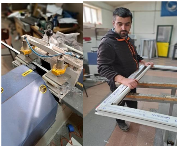
Figura 4.1.2.7. Prerja e listelës (majtas) dhe montimi i listelës te krahu i dritares PVC (djathtas)
